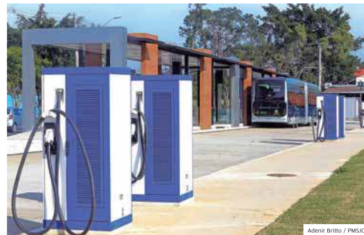
Sul. Carregamento dos VLPs 100% elétricos ocorre no Terminal Sul
