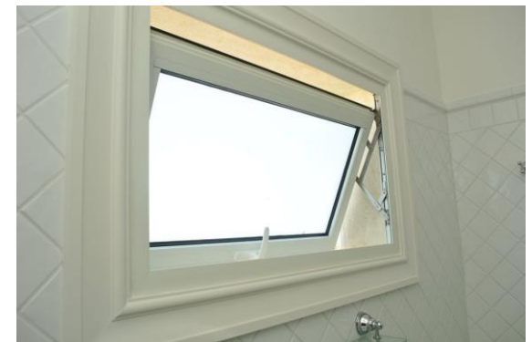
Ventilação Natural no banheiro (10 pontos)
